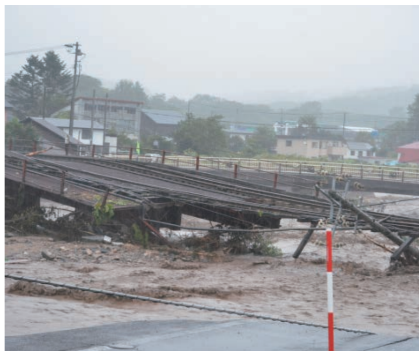
台風10号の影響で氾濫した川に流されてしまった線路や橋(北海道)
